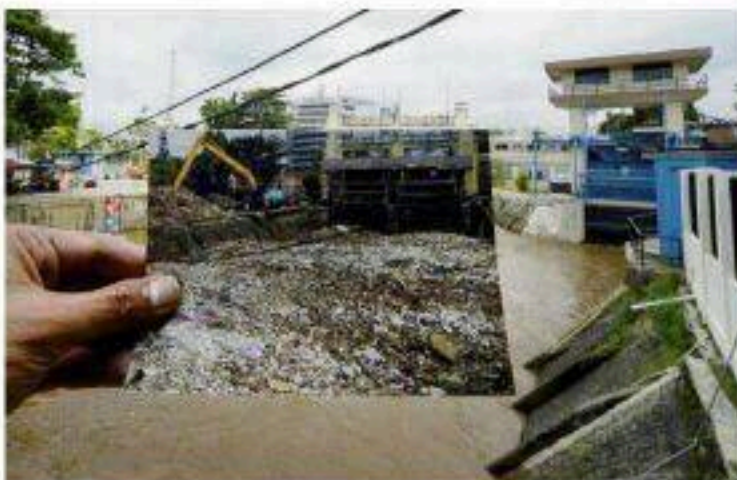
Kondisi Pintu Air Manggarai yang terendam sampah pada Juli 2013 dan situasi Pintu Air Manggarai awal September 2016.
